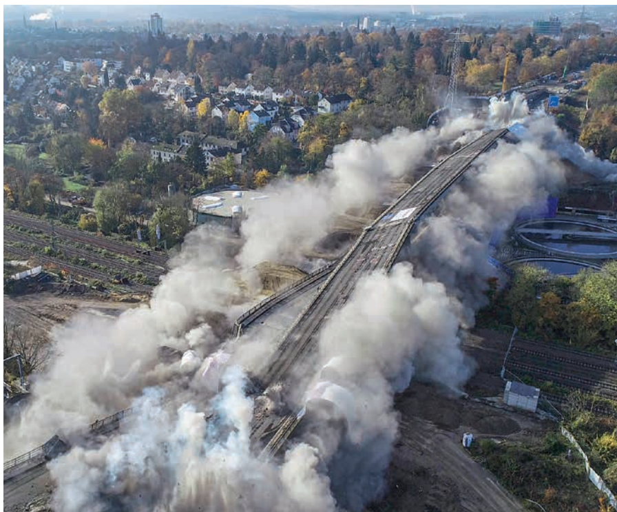
Die rund 300 Meter lange Salzachtalbrücke wurde Anfang November 2021 wegen akuter Einsturzgefahr gesprengt.
